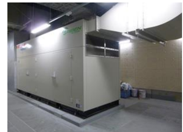
非常用自家発電機
