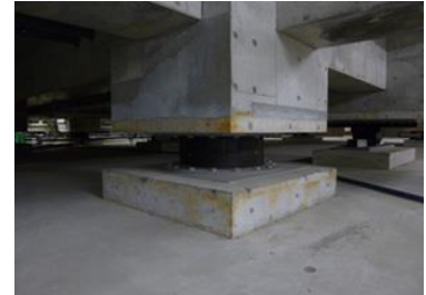
病院本棟の免震構造(積層ゴム)
